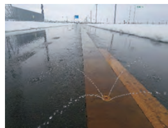
消雪設備（道路融雪）
