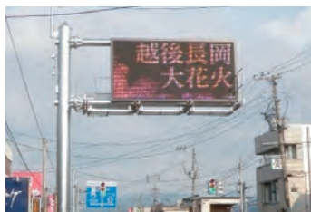
電気設備（道路情報板）
