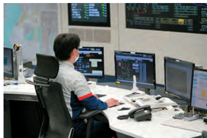
都市ガス供給量制御
