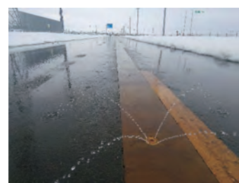
消雪設備（道路融雪）
