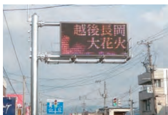
電気設備（道路情報板）
