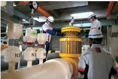
ガス圧力変更設備点検
