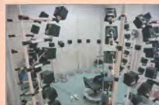
遮音室／音像定位システム設備
