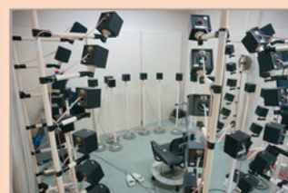
遮音室／音像定位システム設備
