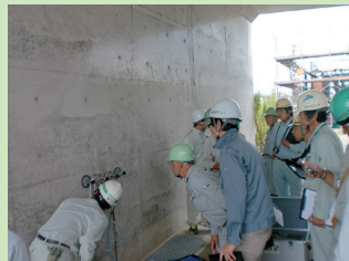
図3 表面吸水試験装置 (SWAT) を用いたコンクリートの品質調査
