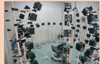
遮音室/音像定位システム設備
