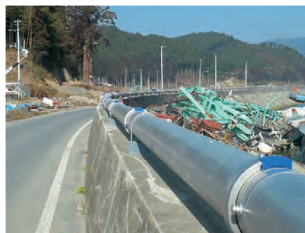
仮設配管レンタル
