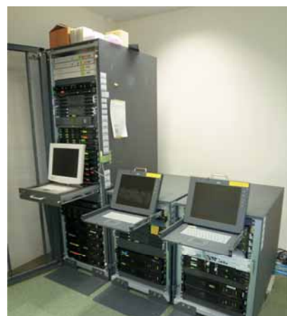
総合情報処理センター サーバ室 Server Room for Networking
