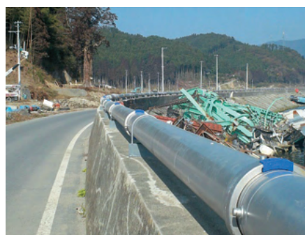
仮設配管レンタル
